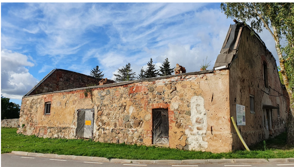
Foto 16. Kaitsealune viinaköök, vaade idast. Pikiseinas otsaseina juures olevad praod võivad osutuda ohtlikuks, kui vesi neisse pääseb. Foto: Mart Hiob 2020.
